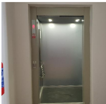
Výtah budova A
